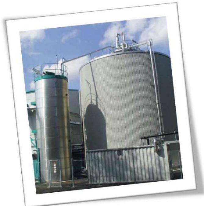
Abb. 12-4: Pilotanlage zur mechanisch-biologischen Abfallbehandlung auf dem „Kahlenberg“
